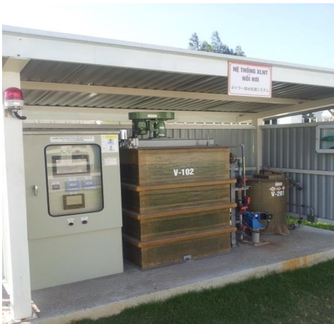
Hình 1- 11: Hình ảnh hệ thống xử lý nước thải nồi hơi của Công ty 表 1-11：会社のボイラー廃水処理システム写真
